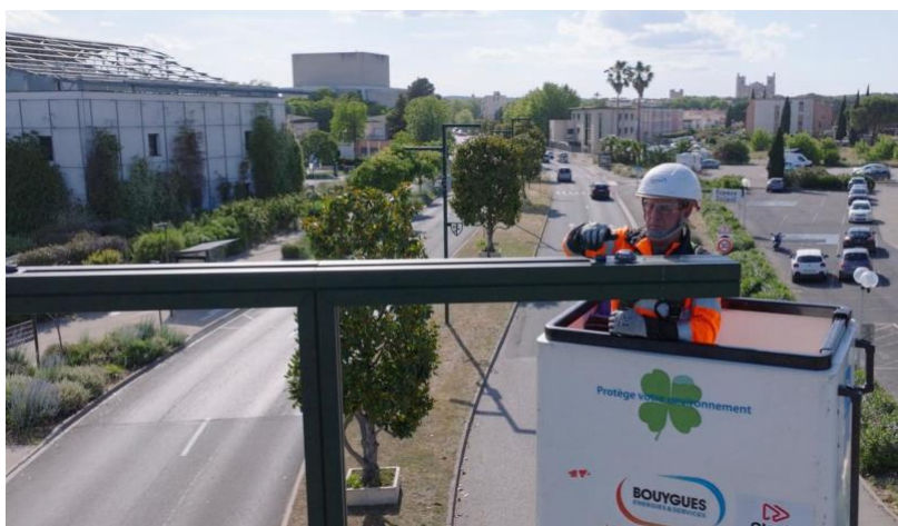
Installation de la solution de télégestion d'éclairage public citybox LoRa sur l'avenue Hubert Mouly ©Creative Corner
